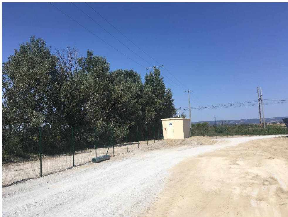
Exemple de poste de livraison
