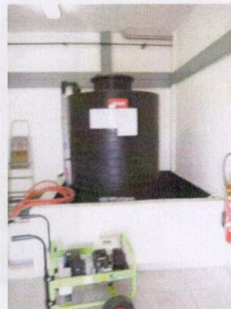
Stockage de soude sur un bac de rétention
