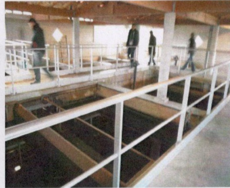
Décanteur au fond et filtres à sables, filtre à charbon actif au premier plan
