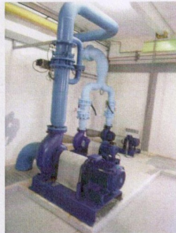
Electropompes de reprise de la bache de break point vers le filtre à charbon actif
