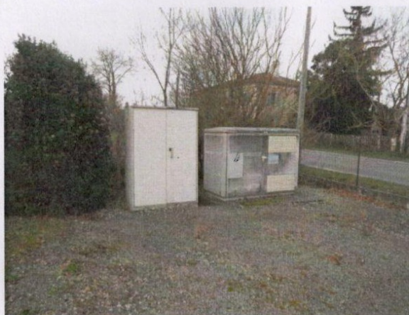
Abri comptage et transformateur
